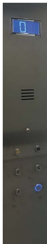
PULSANTIERA DI CABINA CON DISPLAY LCD
